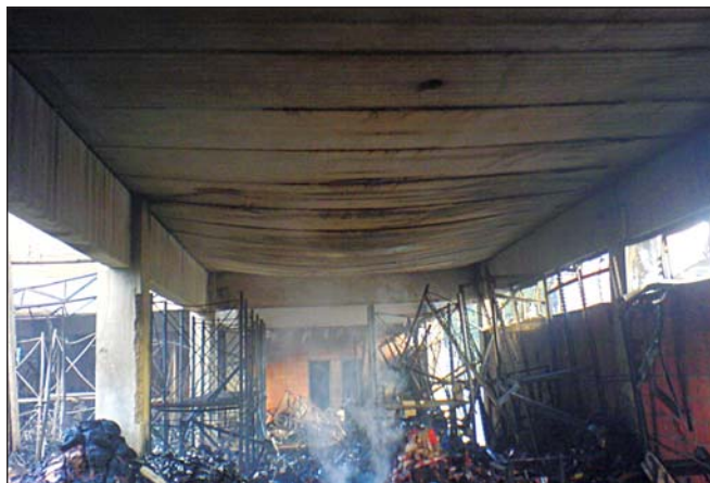
Figura 15: Incêndio no pavimento
