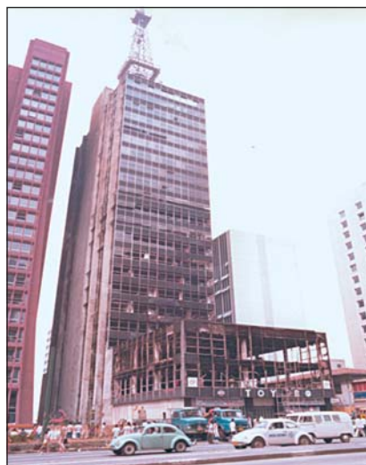
Figura 14: Incêndio no Edifício Grande Avenida
