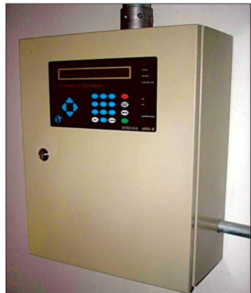
Figura 60: Central de alarme
