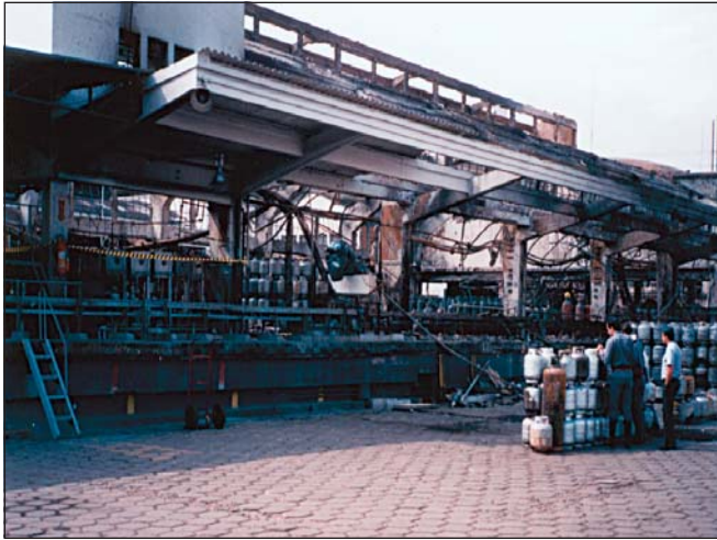
Figura 8: Perícia de incêndio
