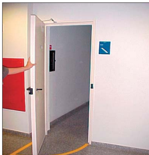
Figura 52: PCF em corredor
