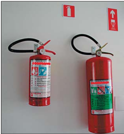
Figura 9: Extintor de incêndio
