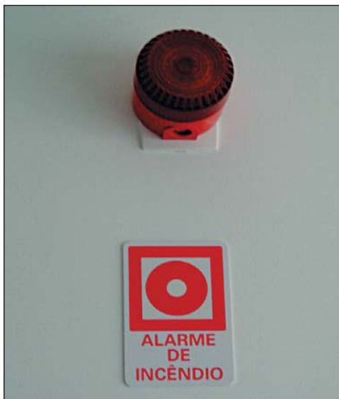
Figura 59: Detalhe de sirene
