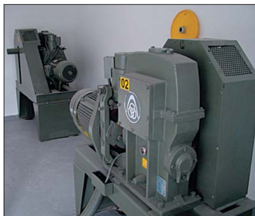
Figura 79: Casa de máquinas dos elevadores
