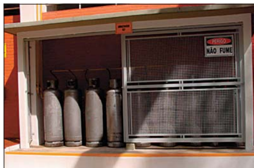
Figura 77: Bateria de GLP
