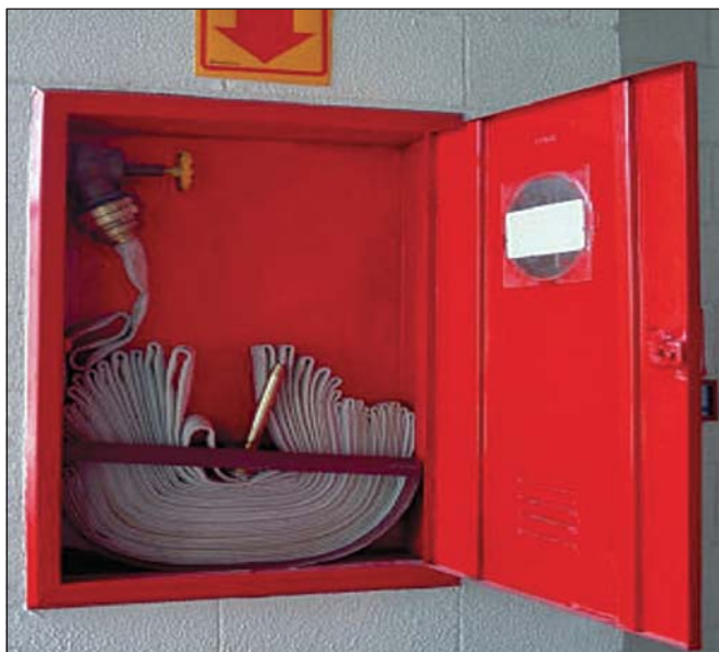
Figura 4: Sistema de hidrantes
