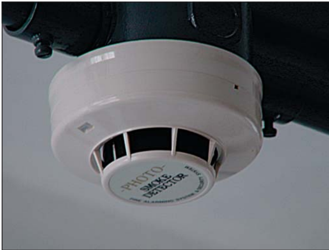
Figura 57: Detector de incêndio
