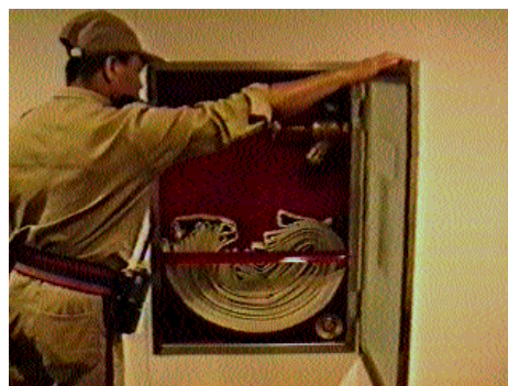
Figura 4 - Sistema de hidrantes
