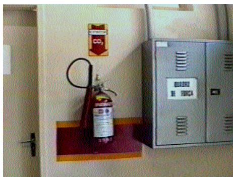
Figura 56 – Sinalização de extintores
