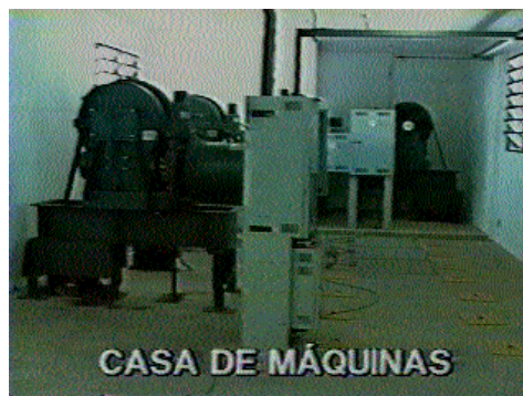
Figura 74 – Casa de máquinas dos elevadores
