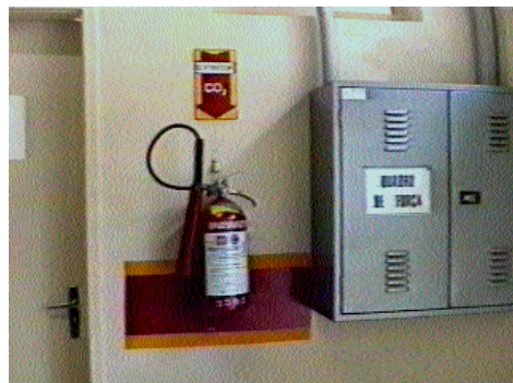
Figura 9 – Extintor de incêndio.
