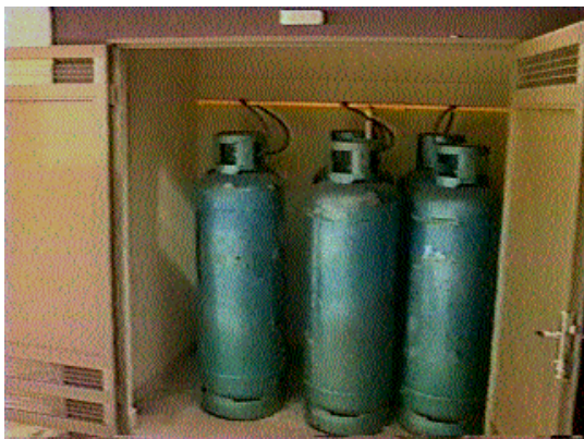
Figura 72 - Bateria de GLP
