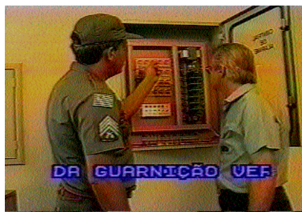
Figura 55 - Central de alarme sofrendo inspeção por bombeiro
