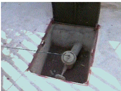
Figura 59 - Registro de recalque para Bombeiros
