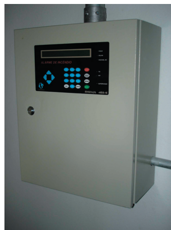
Figura 54 - Central de alarme
