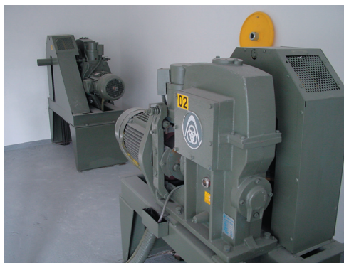
Figura 73 - Casa de máquinas dos elevadores
