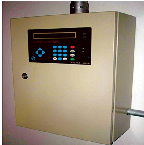
Figura 50: Central de alarme de incêndio
