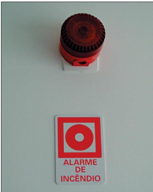
Figura 49: Detalhe de sirene
