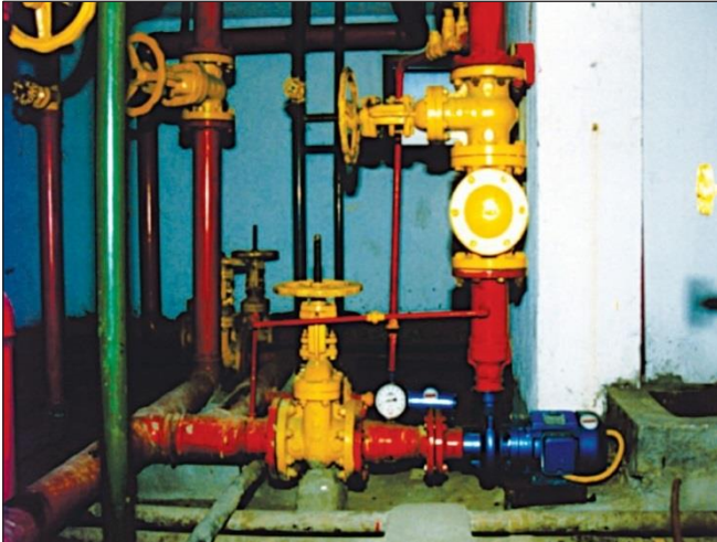
Figura 56: Bomba de incêndio e acessórios hidráulicos
