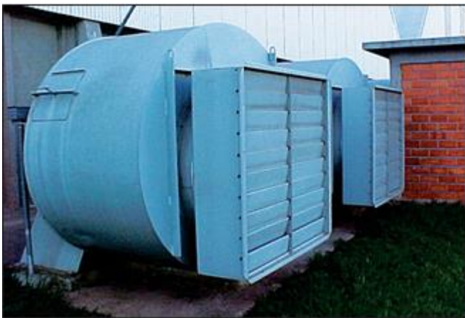
Figura 10: Ventilador ou exaustor
