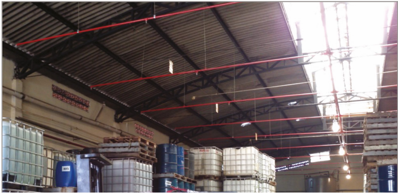
Figura 32 - Distância excessiva entre os chuveiros automáticos e o teto.
