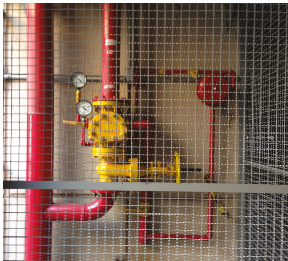
Figura 38 - Conexão de teste de alarme sem placa de identificação.
