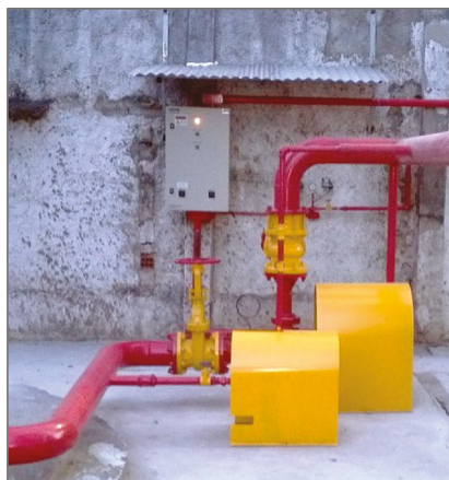
Figura 44 - Falta de casa de bombas.
