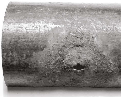
Figura 49 - Tubulação com indícios de MIC.
