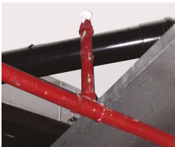
Figura 24 - Chuveiro automático obstruído por tinta.
