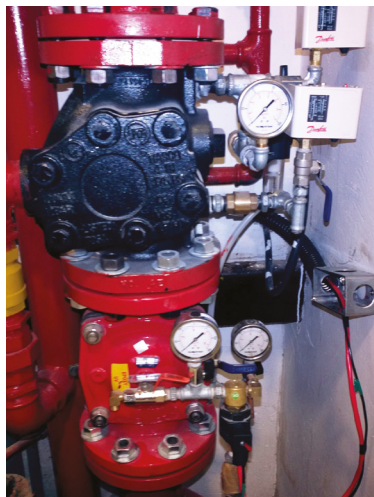
Figura 42 - Manômetros indicam que há falta de água na rede.
