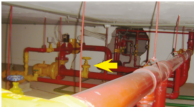
Figura 47 - Emprego de válvula gaveta na sucção da bomba.
