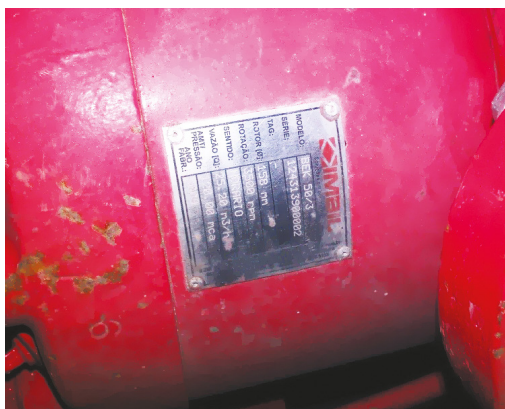
Figura 46 – Placa de identificação da bomba de incêndio.
