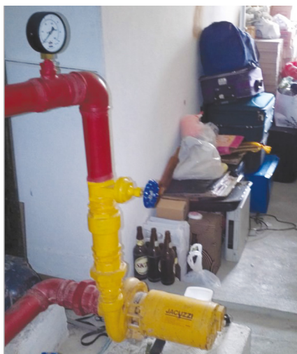
Figura 45 - Acúmulo indevido de carga de incêndio na casa de bombas.
