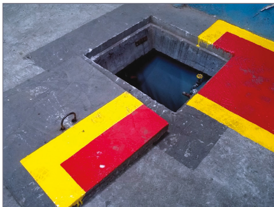
Figura 52 - Reservatório do sistema de chuveiros automáticos vazio.
