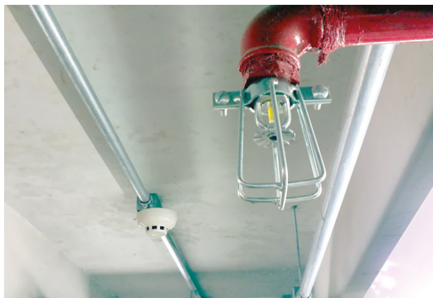
Figura 27 - Proteção adequada para o chuveiro automático.
