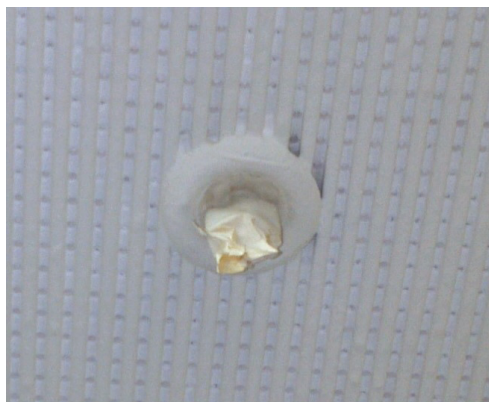
Figura 23 - Chuveiro automático obstruído por fita adesiva.
