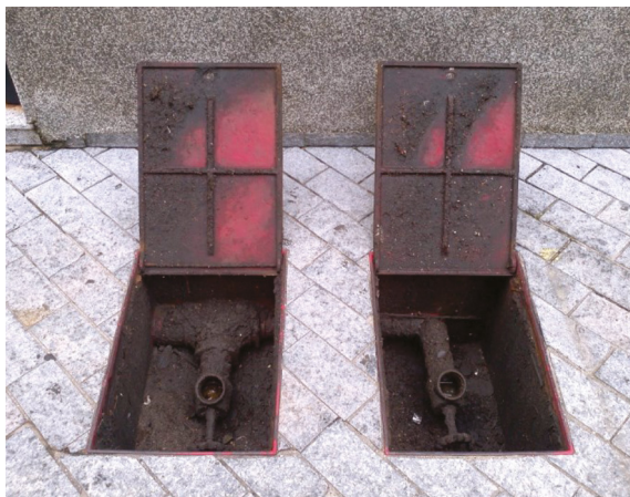
Figura 51 - Dispositivo de recalque obstruído por detritos.
