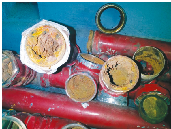
Figura 50 - Tubulação obstruída por detritos.
