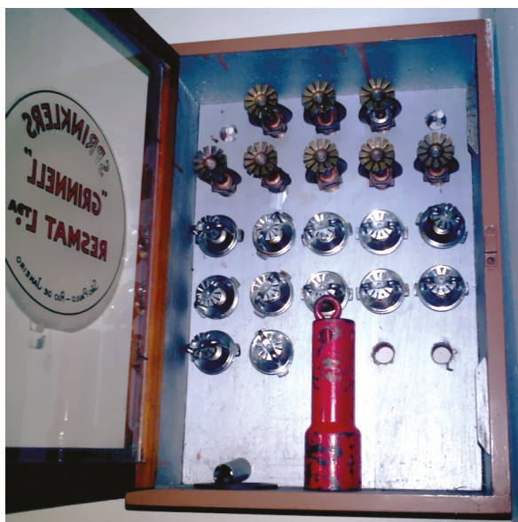
Figura 33 - Armário com chuveiros sobressalentes.
