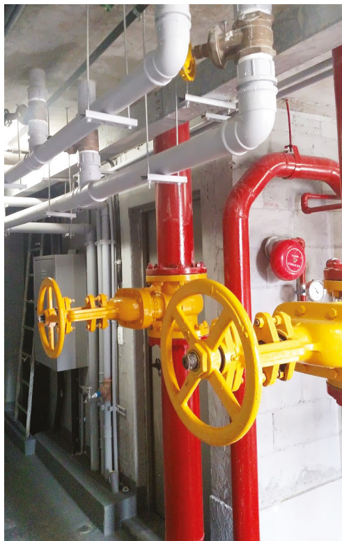
Figura 53 - Válvula tipo haste ascendente instalada na saída do reservatório e na posição fechada.
