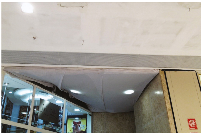
Figura 26 - Chuveiro automático obstruído por forro provisório.
