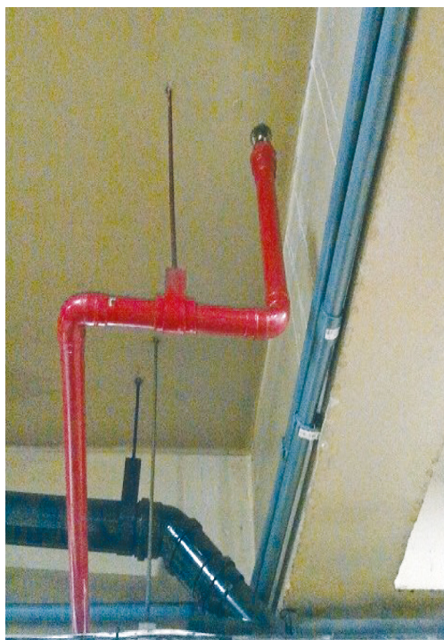
Figura 29 - Chuveiro automático com área de cobertura obstruída por viga.
