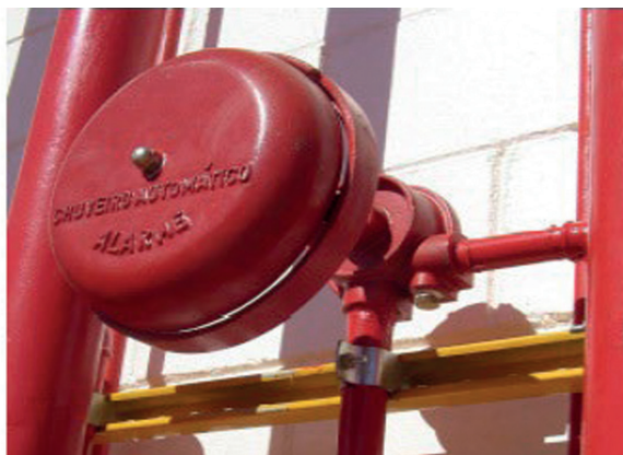
Figura 9 - Gongo hidráulico de alarme
