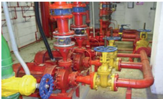
Figura 4 - Exemplo de uma casa de bombas para um sistema de chuveiros automáticos
