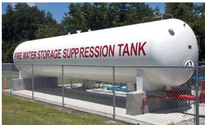
Foto 3 - Exemplo de tanque de pressão para armazenamento de água
