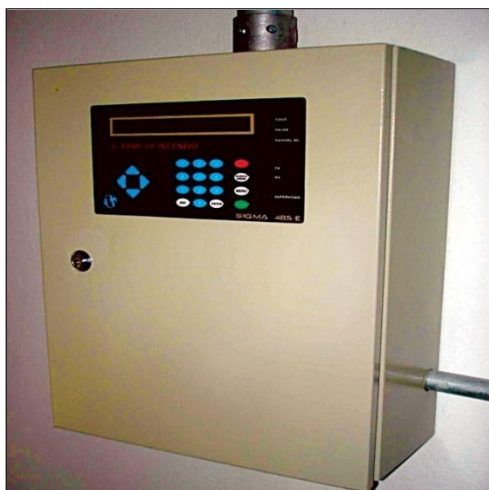
Figura 51: Central de alarme de incêndio.
