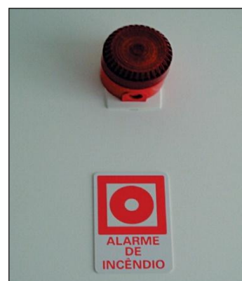
Figura 50: Detalhe de sirene.
