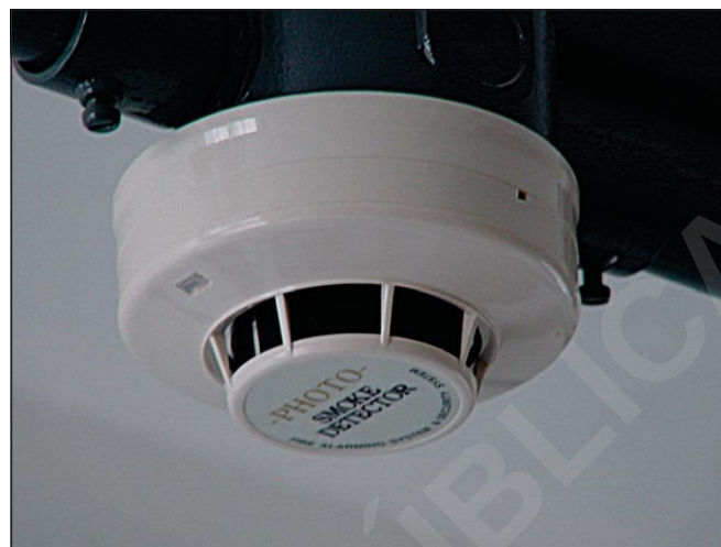
Figura 48: Detector de incêndio.
