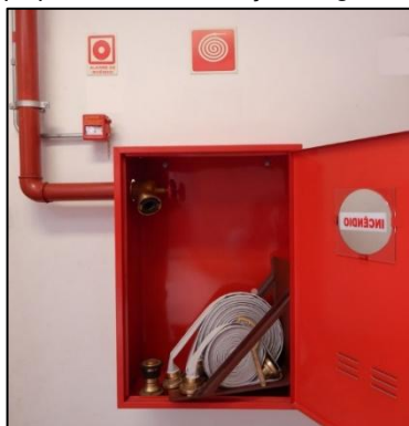
Figura 56: Detalhe de hidrante.
