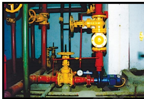
Figura 57: Bomba de incêndio e acessórios hidráulicos.
